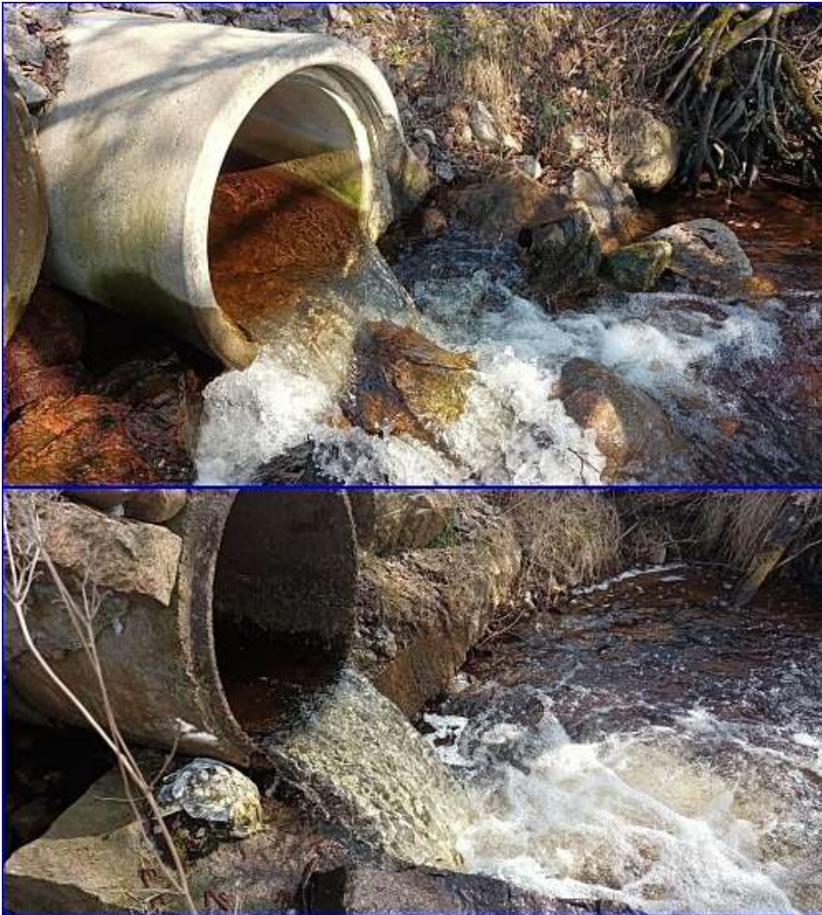
Figur 106: Exempel på vandringshinder i form av vägtrummor i Prästabäcken (D1 övre bilden, D2 undre bilden).
